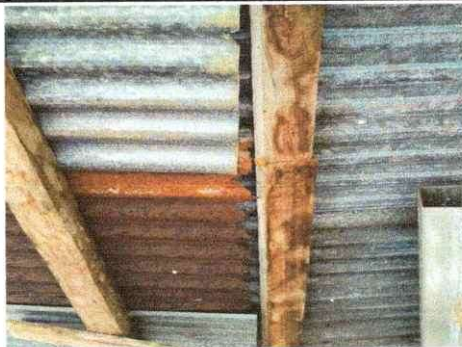
Foto 5: Techo que necesita mantenimiento
