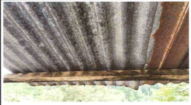
Foto 2: Láminas en deterioro y con agujeros
