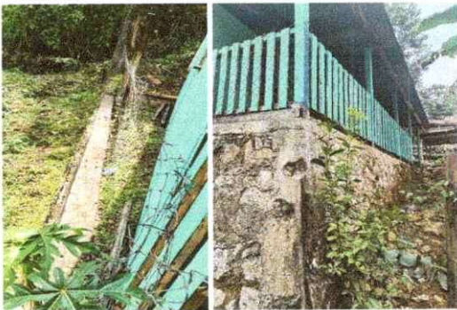
Foto 5: Deterioro del muro de la cocina
