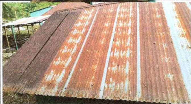
Foto 1: Condición de las láminas del salón de clases, actualmente
