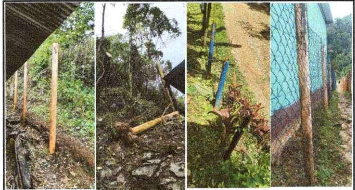
Foto 4: Cerco perimetral de la escuela en malas condiciones.
