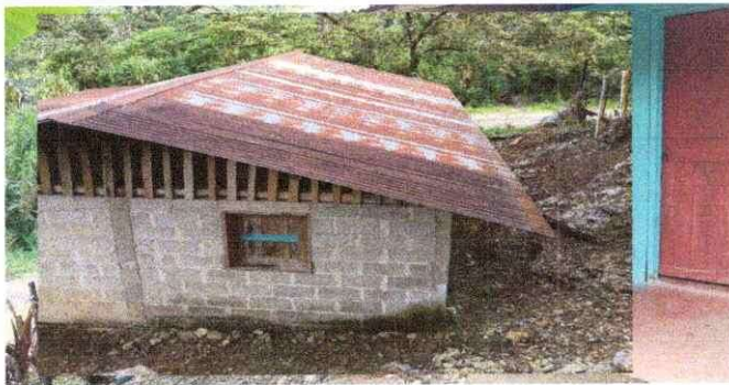
Foto 3: Edificio escolar que necesita mantenimiento.
