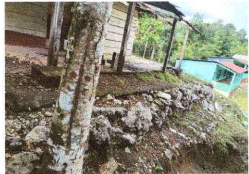
Foto 4: Necesidad de muro y piso para salón de clases
